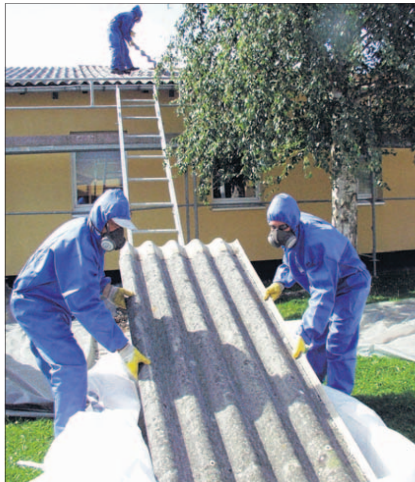
Mit Schutzmaske und -anzug entsorgen Männer der Schwaaner Firma Lehwald die Asbestplatten vom Dach der Kindertagesstätte in Neubukow.
